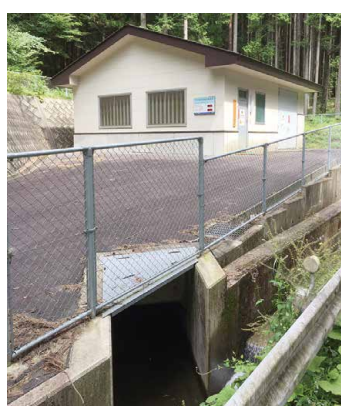
④加子母清流発電所 外観 写真下の放水路から発電後の水を農業 用水に戻す
