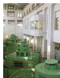
②大井発電所 内部 4基の発電機
