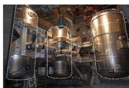
放射性物質の放出量を大幅に抑制する設備
